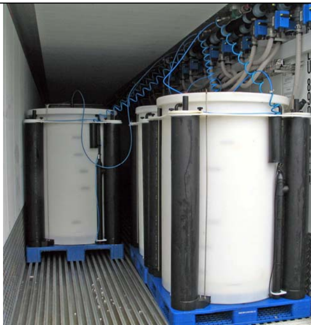
a) 10 lagringstanker kan plasseres i en kjølecontainer.
